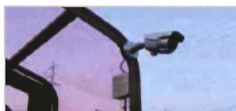
管工事業業様×盗難防止
